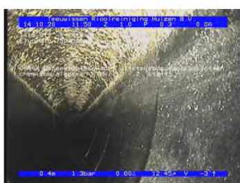
1010_204.jpg, 00:00:50, 0.44m Oppervlakteschade, uitbrekende toelaststoffen, chemisch algemeen kloot: 10 - 2, start
