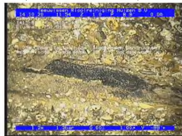
1010_206.jpg, 00:02:32, 1.25m Oppervlakteschade, bogenomen wandruwheid, mechanische schade kloot: 12 - 1, op een voeg
